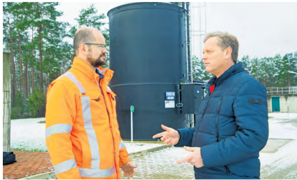
Verbandsgeschäftsführer des WAZV „Elbe-Elster-Jessen“ Thomas Giffey (re.) mit Klärwerksleiter Silvio Junge auf der Kläranlage Jessen. Im Hintergrund steht die Eisen-III-Chlorid-Dosieranlage, deren Inhalt nur noch schwer zu beschaffen ist. Alternativen müssen her, um das Abwasser weiterhin sicher zu behandeln.
