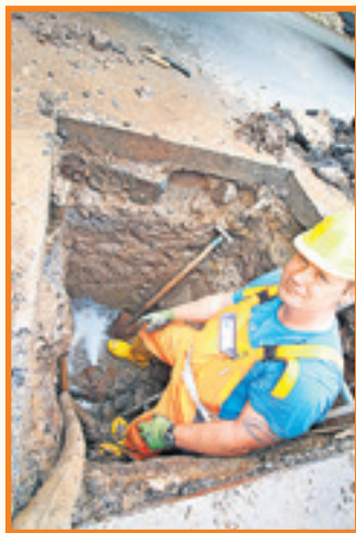
„Da ist das Problem!“ Kurz darauf machten Silvio Glanz und seine Kollegen den Rohrbruch unschädlich.
