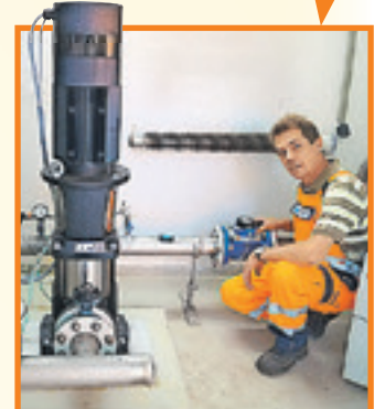
Ulrich Jecht am elektronischen „Herz“ der Druckerhöhungsanlage in Amesdorf
