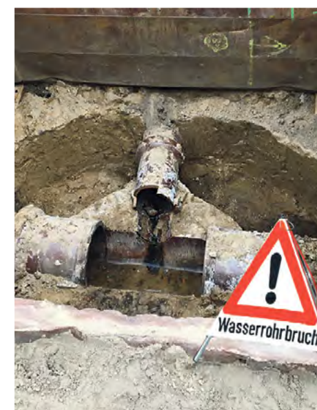
Wasserrohrbrüche müssen vermieden bzw. schnell lokalisiert werden, sonst steigen die Wasserverluste stark an. Foto: SPREE-PRV/G. Schulze
