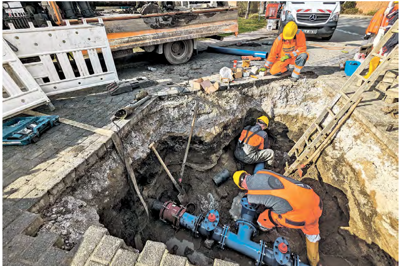
Geht nur mit einem guten Konzept und fleißigen Händen: So wie hier in der Ortslage Tarthun in der Egelnschen Straße wird das Trinkwasser erneuert, um dauerhaft eine sichere Versorgung zu gewährleisten.
