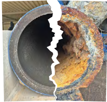
Neues Rohr – altes Rohr: Unsere Bildcollage zeigt den Vergleich. Ganz klar, hier ist Handlungsbedarf angesagt, ansonsten leidet die Trinkwasserqualität.
