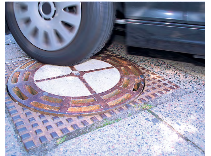
Nach dem Beitrag in der letzten Wasserzeitung gingen beim WAZV Hinweise zu weiteren klappernden Gullydeckeln ein. Foto: SPREE-PR/Petsch
