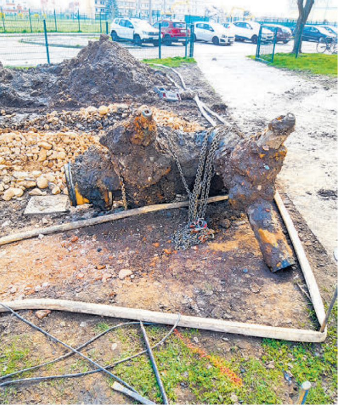
Alle verbauten Schieberkreuze in besagtem Bauabschnitt befanden sich in ähnlich schlechtem Zustand, weshalb es notwendig war, diese auszutauschen.
