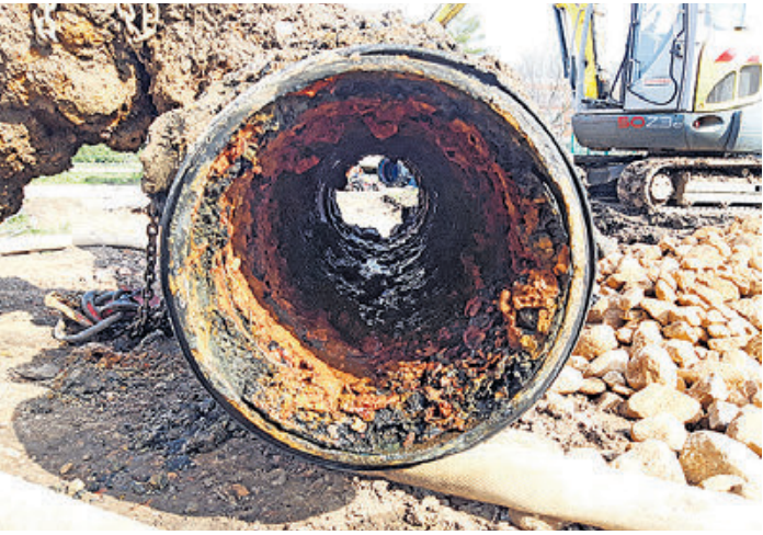
Zugesetzte und beschädigte Rohre – wie oben zu sehen – mussten ersetzt werden, um weitere Wasserverluste zu verhindern.
