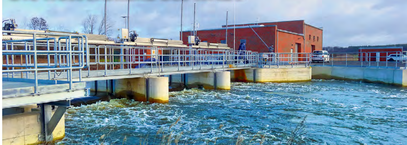
Der Weg des Wassers: Das Pumpwerk Satuelle transportiert jährlich bis zu 24 Millionen Kubikmeter Ohrewasser über einen 12 km langen Kanal nach Colbitz zur Grundwasseranreicherung. Foto: TWM
