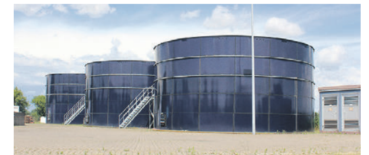
Die Schlammstapelbehälter der Kläranlage Hecklingen: Dort wird der Überschussschlamm aus den Nachklärbecken statisch eingedickt.
