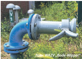
Ein Saugstutzen an der Grundstücksgrenze erleichtert die Arbeit.
