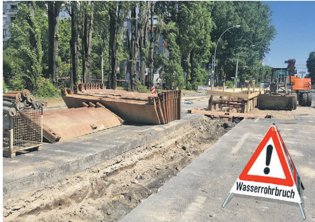
Wasserrohrbrüche – wie hier ein Beispielfoto – werden schnellstmöglich behoben, um die Trinkwasserversorgung zu sichern und die Wasserverluste gering zu halten. Foto: SPREE-PR/Schulze
